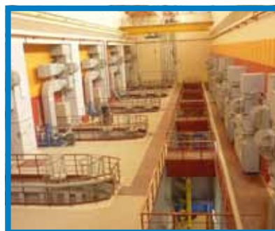
CH Grodnenskaya Interior de la Casa Máquinas
